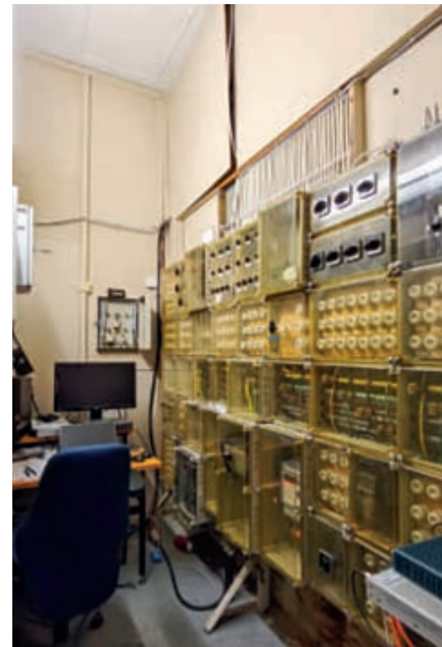
Sähköpääkeskus (NAC Arkkitehdit, 2025)
