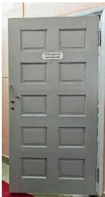
Ovi urkuparven porrashuoneeseen
